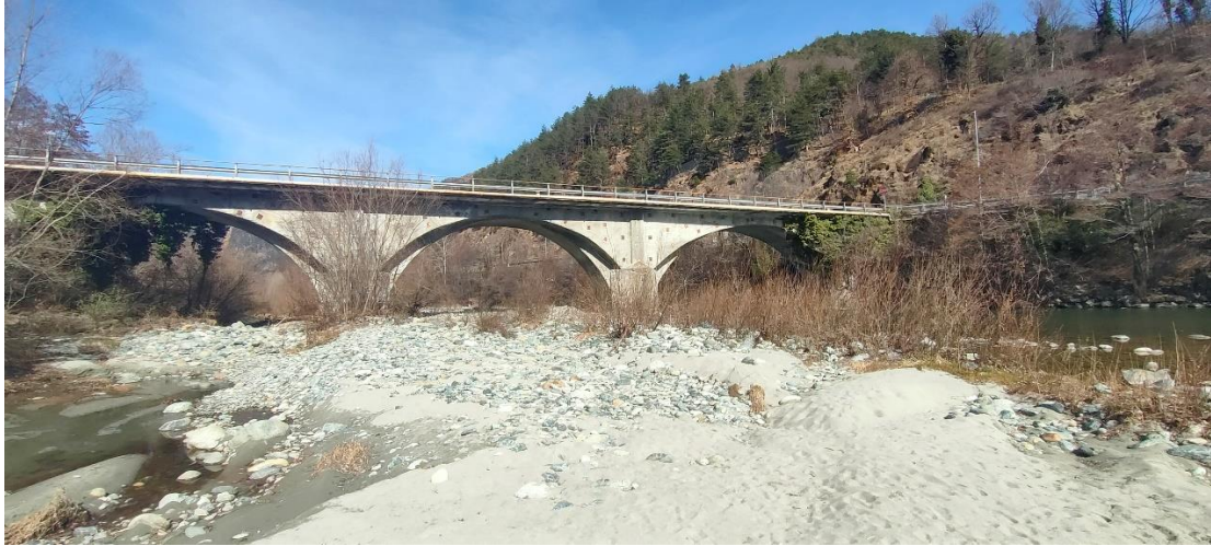
Ponte codice 15 schede SICOD situato a monte del concentrico che collega il cimitero
